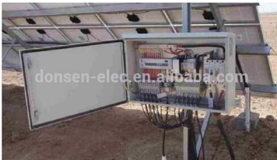
Slika 4. Primjer sabirnog ormara uz nosač metalne konstrukcije
